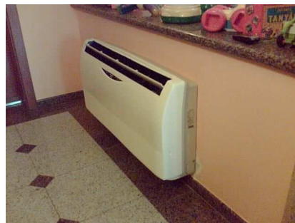
6. ábra. Oldalfali parapetes klíma 7
